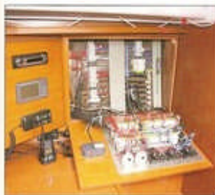
Le tableau électrique est un bel exemple du soin apporté à la finition et à la qualité des éléments.
